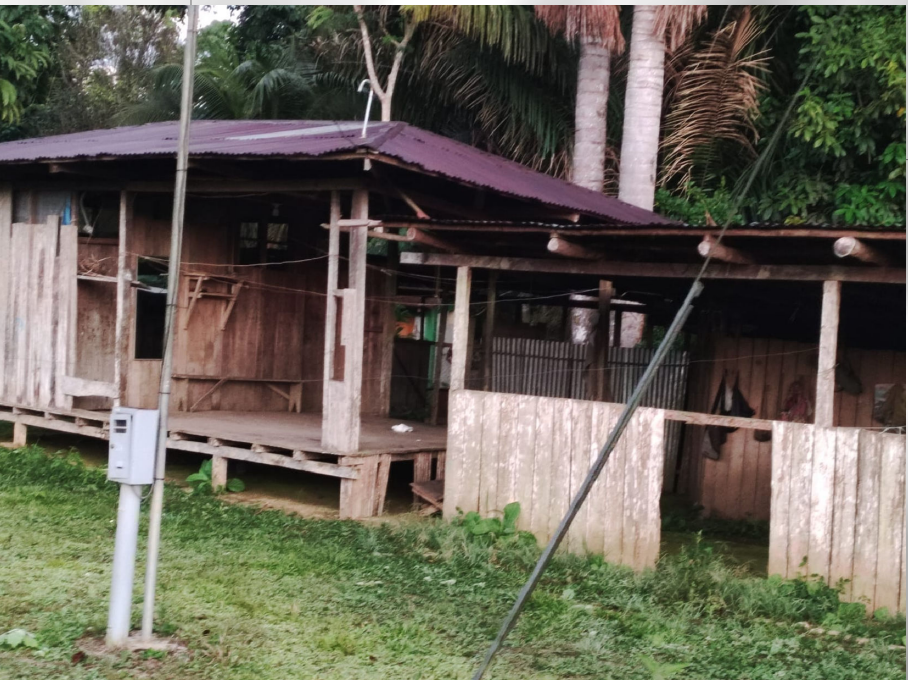
ESTADO DE CONSERVACION: MALO
